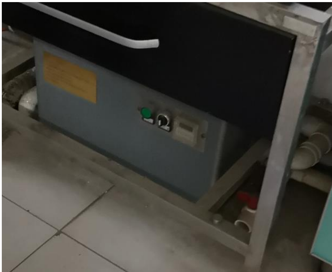
图 4-2 项目污水处理设备
