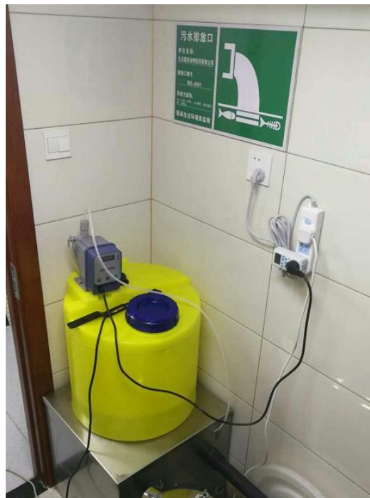
图 4-2 项目污水处理设备图
