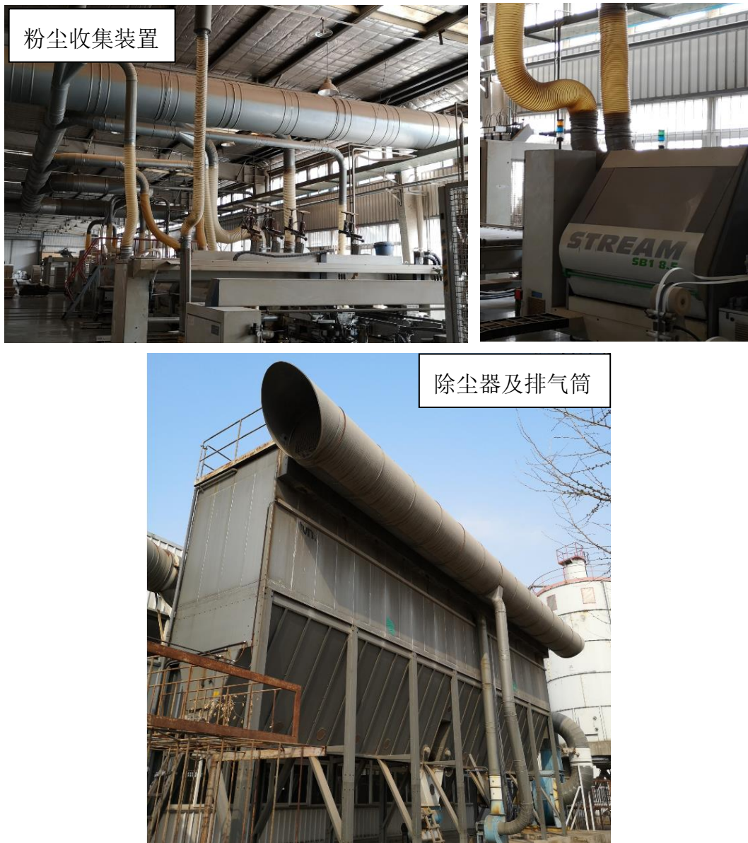
图 4-2 废气治理设施照片
