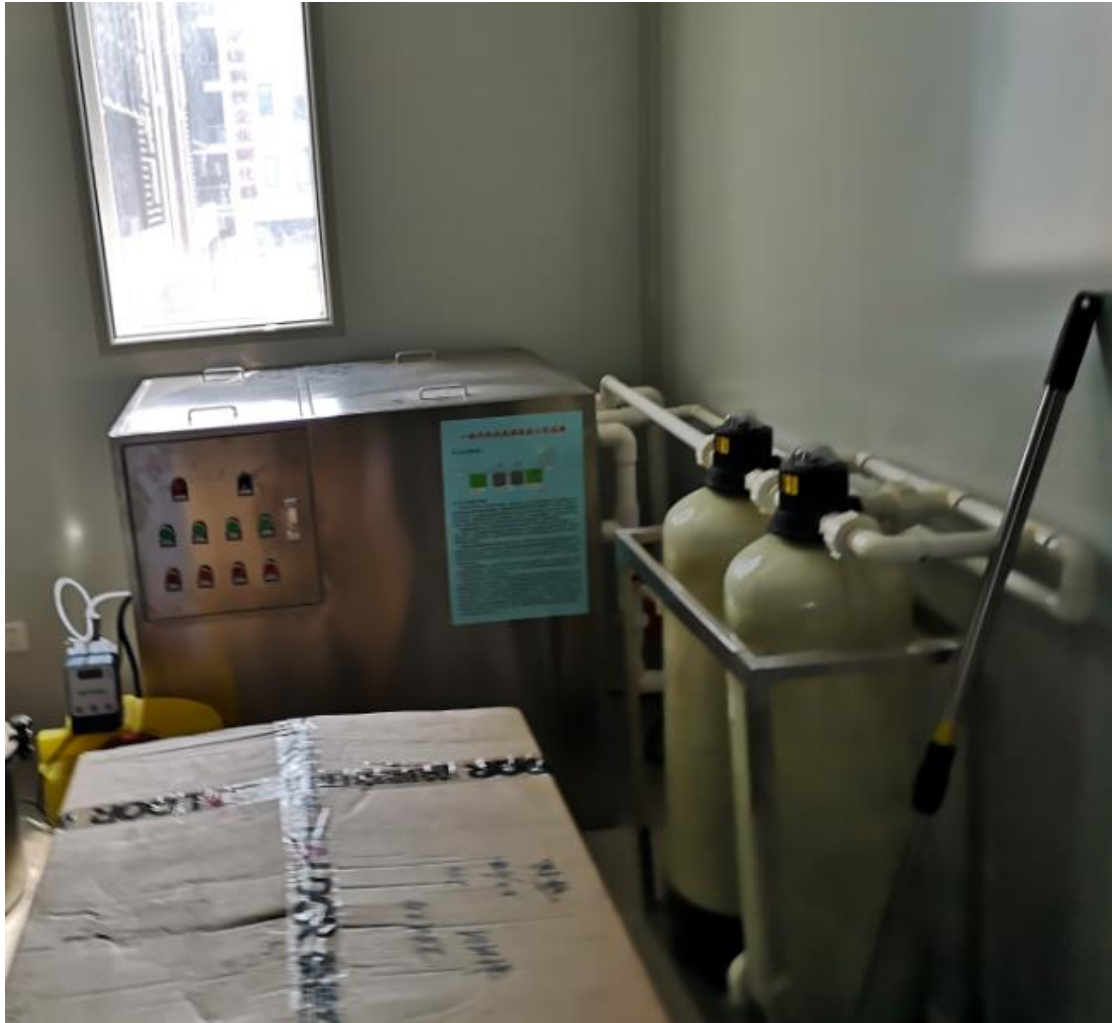
图 4-3 项目污水处理设备图
