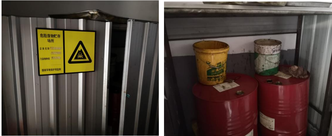
图 4-1 危险废物暂存设施照片
