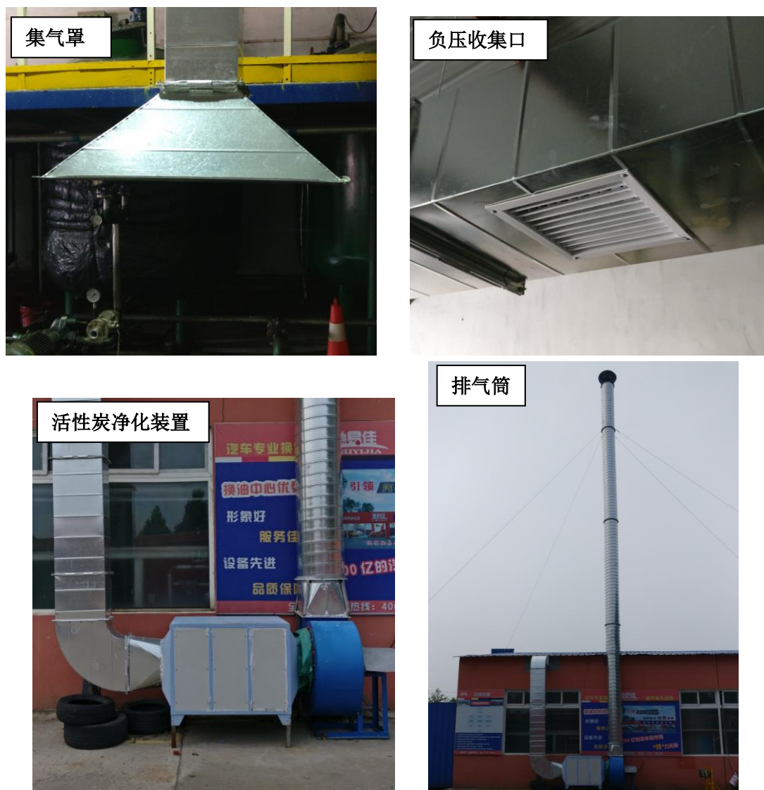
图 4-1 废气治理设施照片
