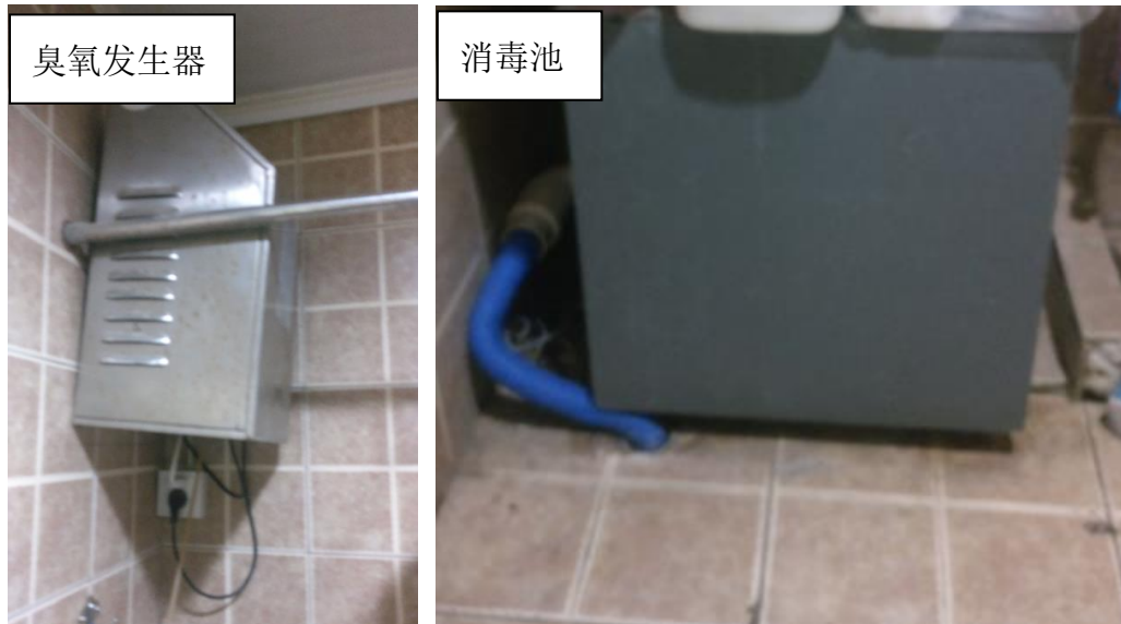
图 4-2 项目污水处理设备图
