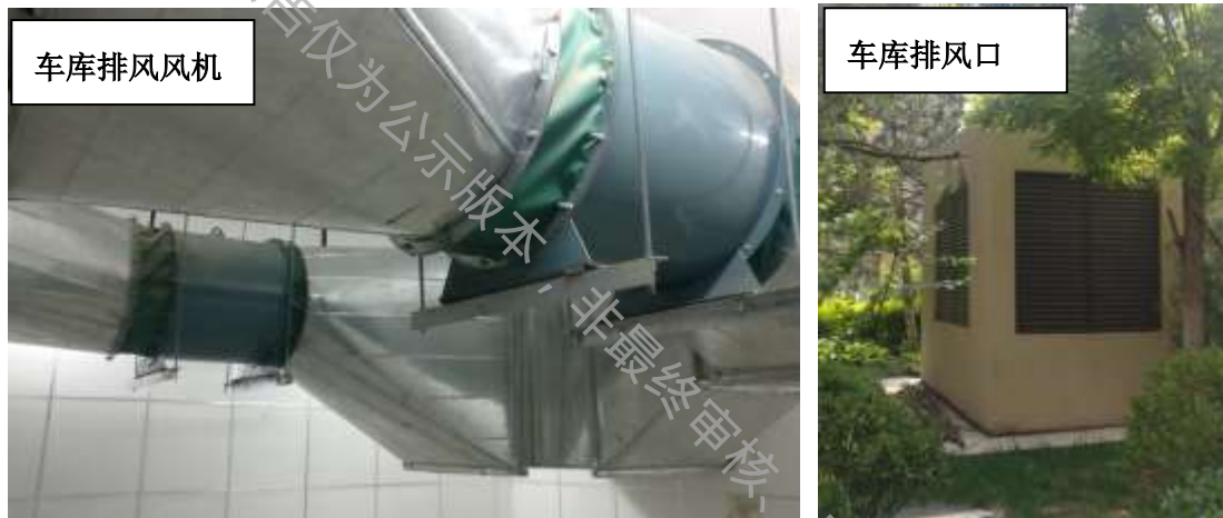
图 4-1 车库排气设施
